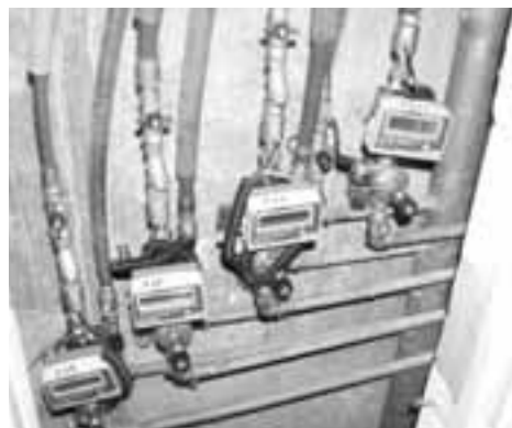
Рис. 9.12. Размещение квартирных тепломеров на лестничной площадке
