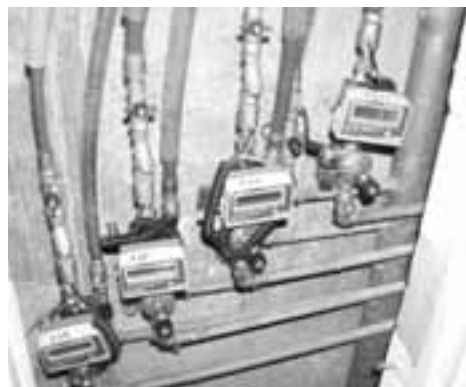
Рис. 9.12. Размещение квартирных тепломеров на лестничной площадке
