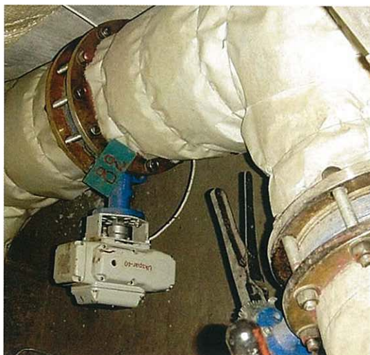
Рис. 3. Узел регулирования с косыми врезками и проходным регулирующим клапаном, установленный на ЦТП-6 в Коммунарском районе Запорожья
