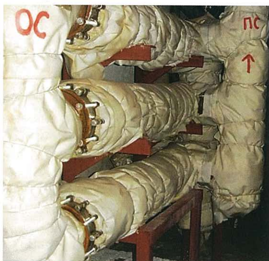
Рис. 4. Блок из трех интенсифицированных теплообменных аппаратов ТТАИ диаметром 200 мм и длиной 1 500 мм в системе устойчивого регулирования ЦТП отопительной мощностью 16,8 Гкал/ч
