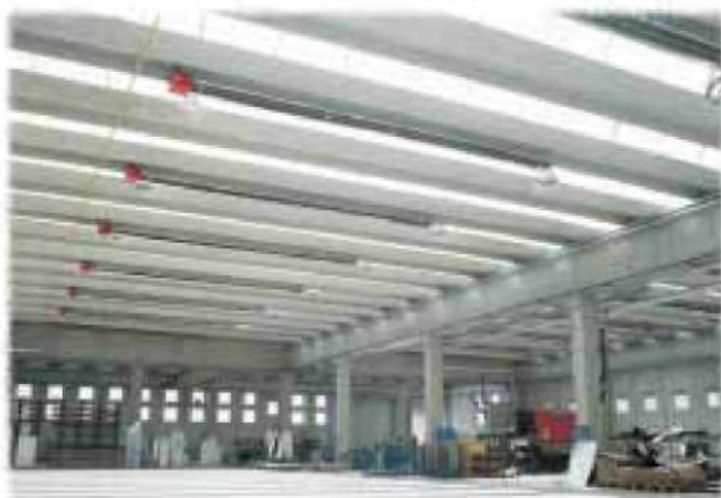
Рис. 10 Система отопления PANRAD: цех производства холодильных установок
