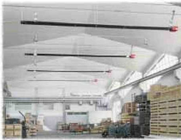
Рис. 11 Система отопления PANRAD: цех металлоконструкций
